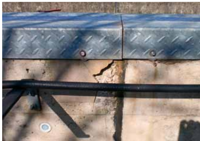
Schlecht sanierter Beton – der Verfall kommt von innen ...
