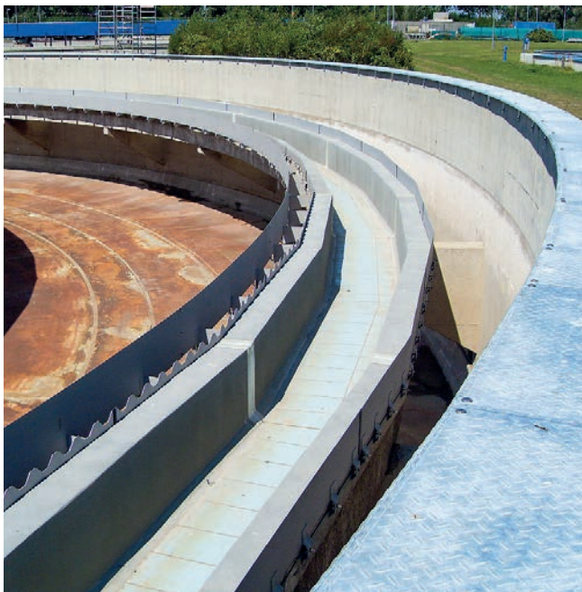
Zackenschwelle und Überlaufwehr aus Edelstahl
