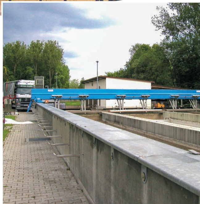
Räumlerlaufbahn auf Längsbecken
