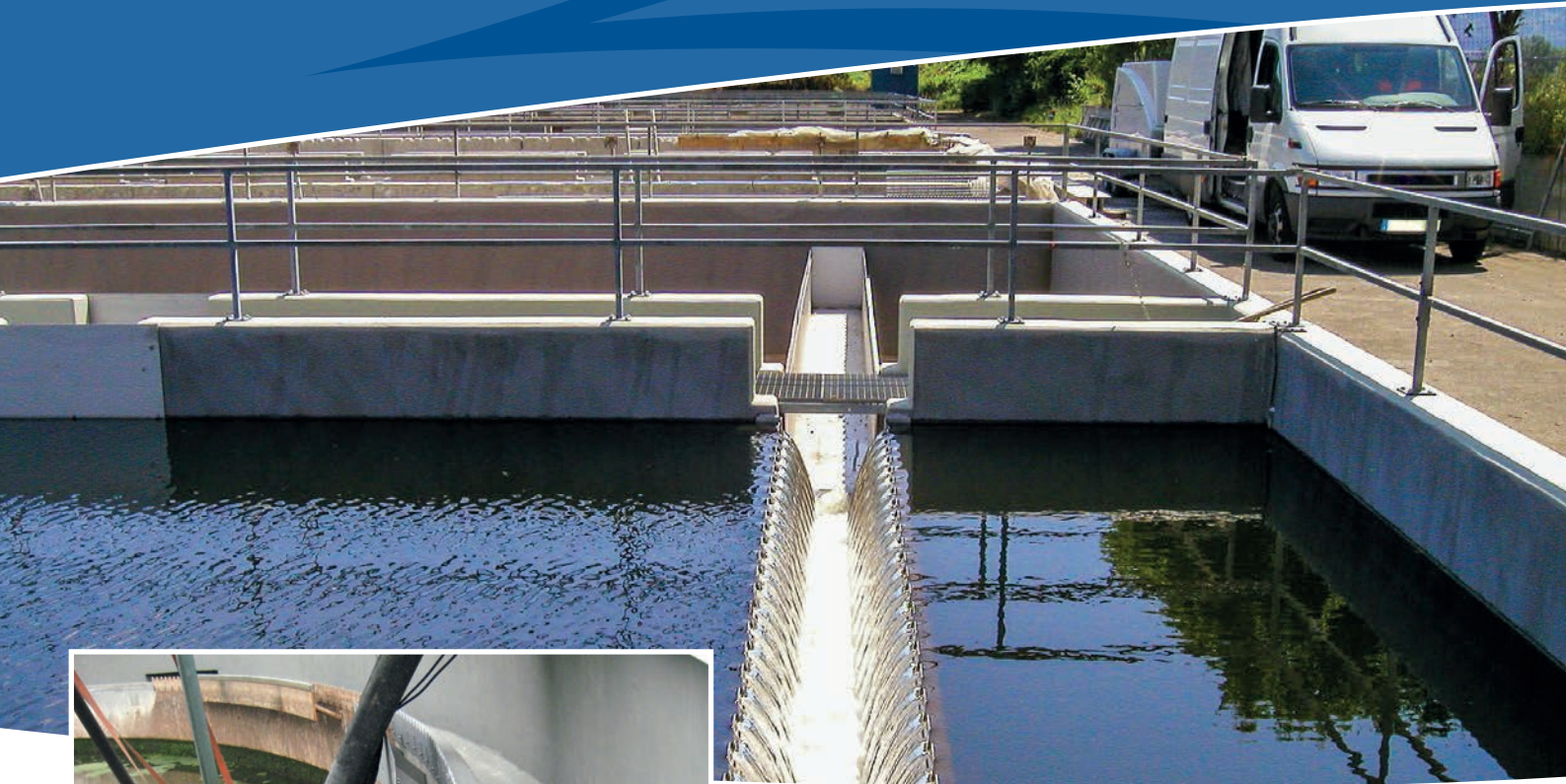
Canali di scarico in acciaio inox
